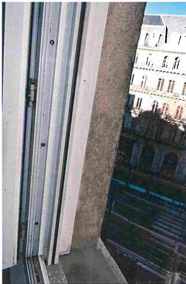
Intégrité du chambranle gauche de la fenêtre
