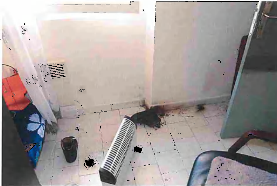
Des marques de brûlures sur le sol sous la fenêtre
