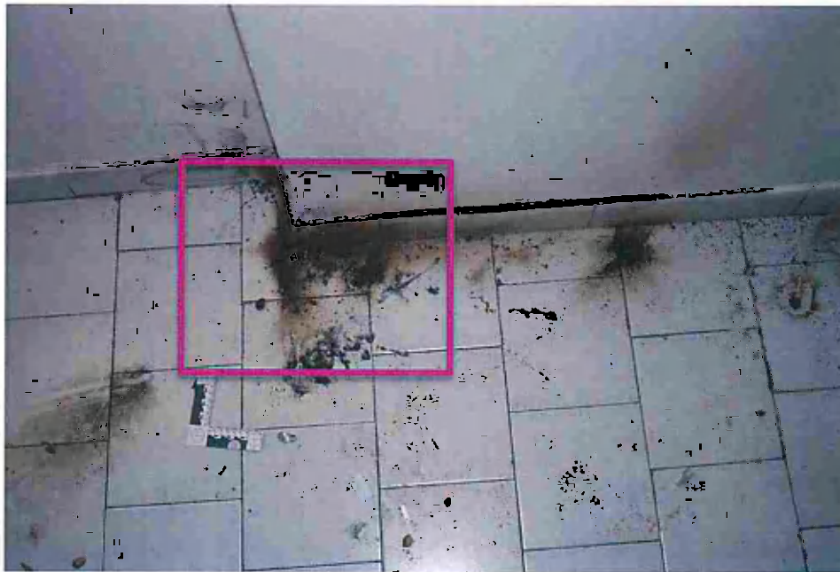
Les traces de combustion au sol
