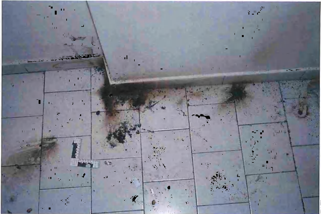
Les traces de combustion au sol
