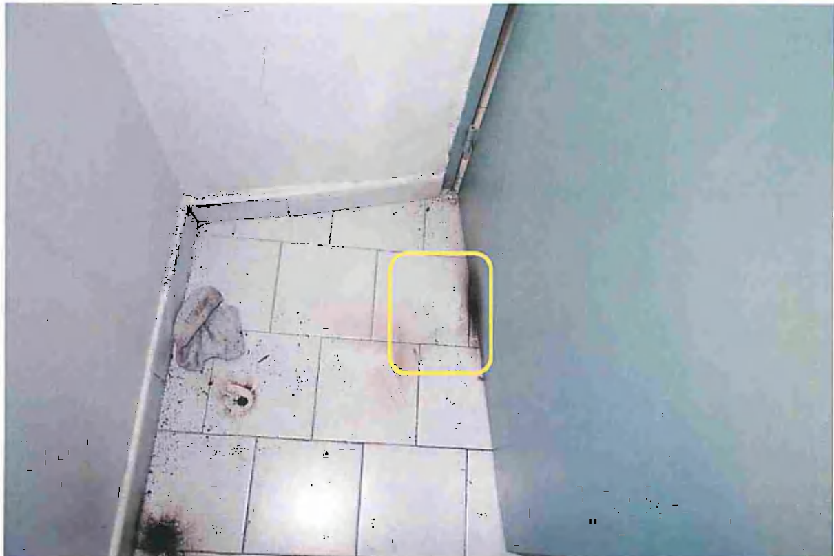
Vue de la position de la porte lors de l'explosion de la grenade à l'intérieur de l'appartement
