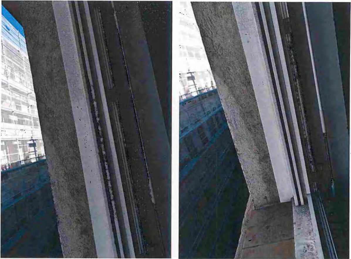
Intégrité du chambranle droit de la fenêtre
