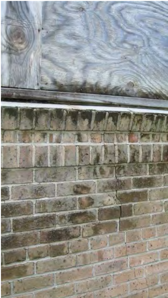
A24 Exterior- Crack Below Sill
