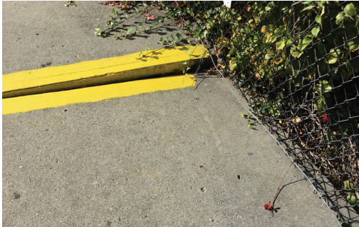
Fig 032. Uneven Pavement Exceeding 1/2"
