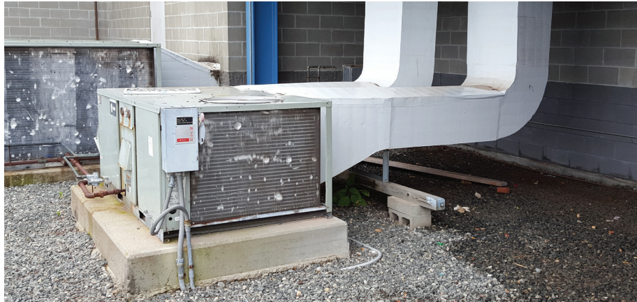
Fig. 052. Exterior Package Unit
